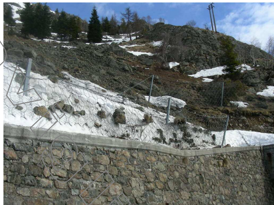
Fig. 04: terzo impatto → blocchi rocciosi su barriera parzialmente caricata dalla neve (foto 25/03/14).
